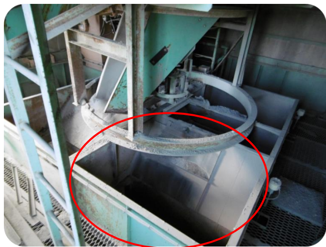
プラント貯蔵ビン(スラグ用)
