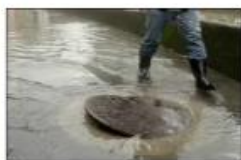
マンホール蓋外れ
