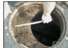
ボルト無締結の古いタイプのマンホール蓋の横ズレ
