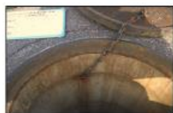
緩番のないマンホール蓋
