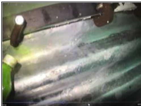
漏水確認（黄インク水）
