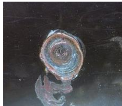
キャッチクランプ解体後の傷
