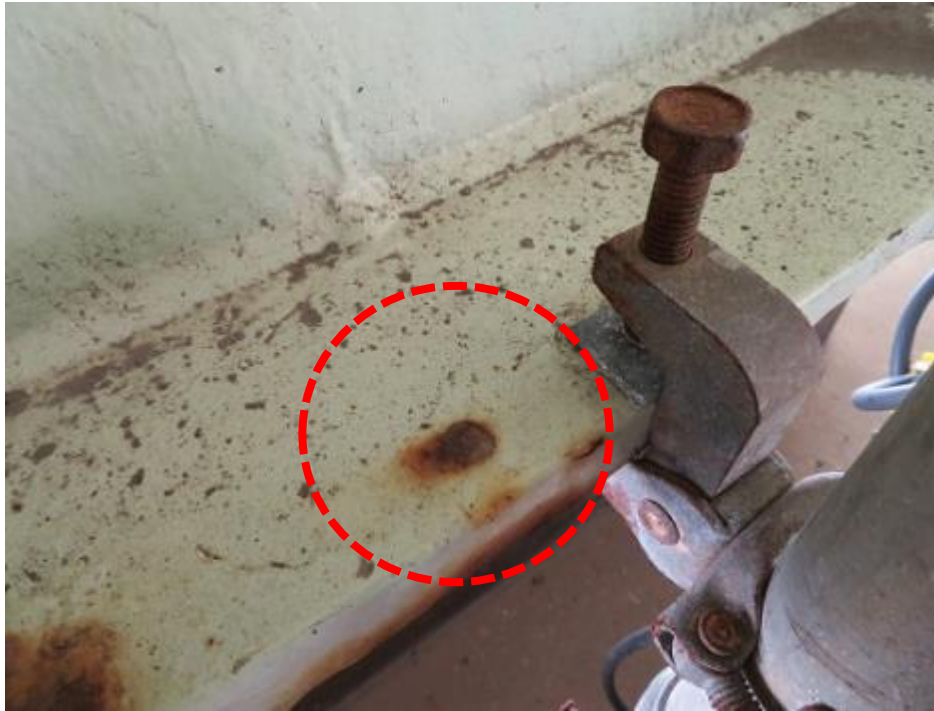
初期の塗膜劣化
