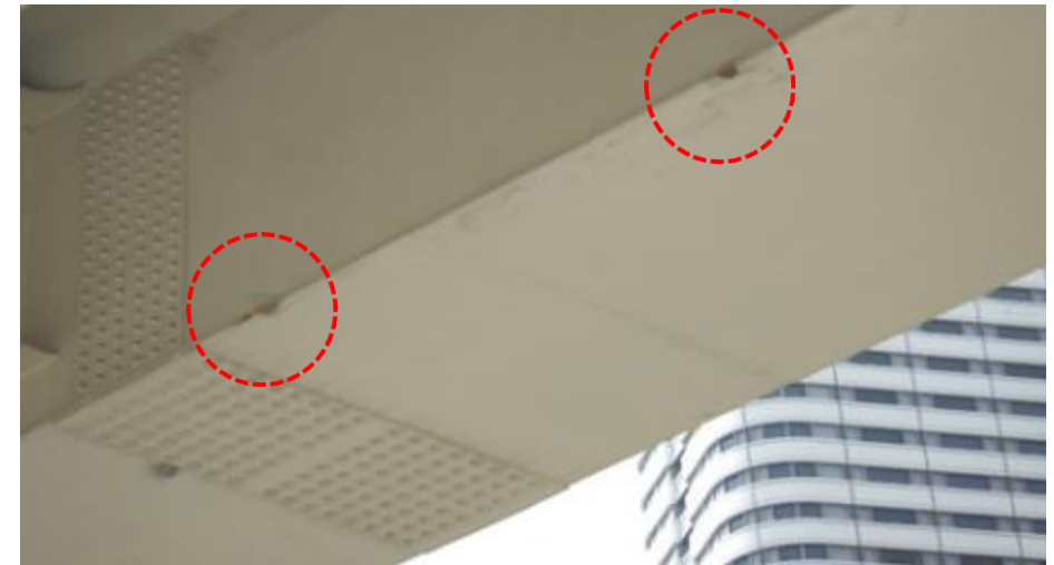
塗替え後の塗膜劣化箇所例
