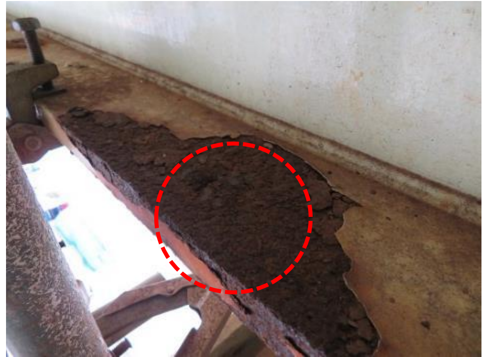
キャッチクランプ跡を起点に錆が広がる
